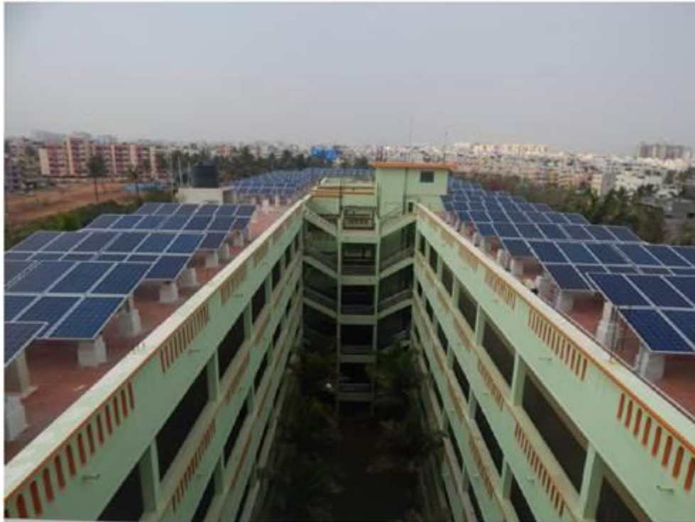
Vagdevi Villas - 100KWp
